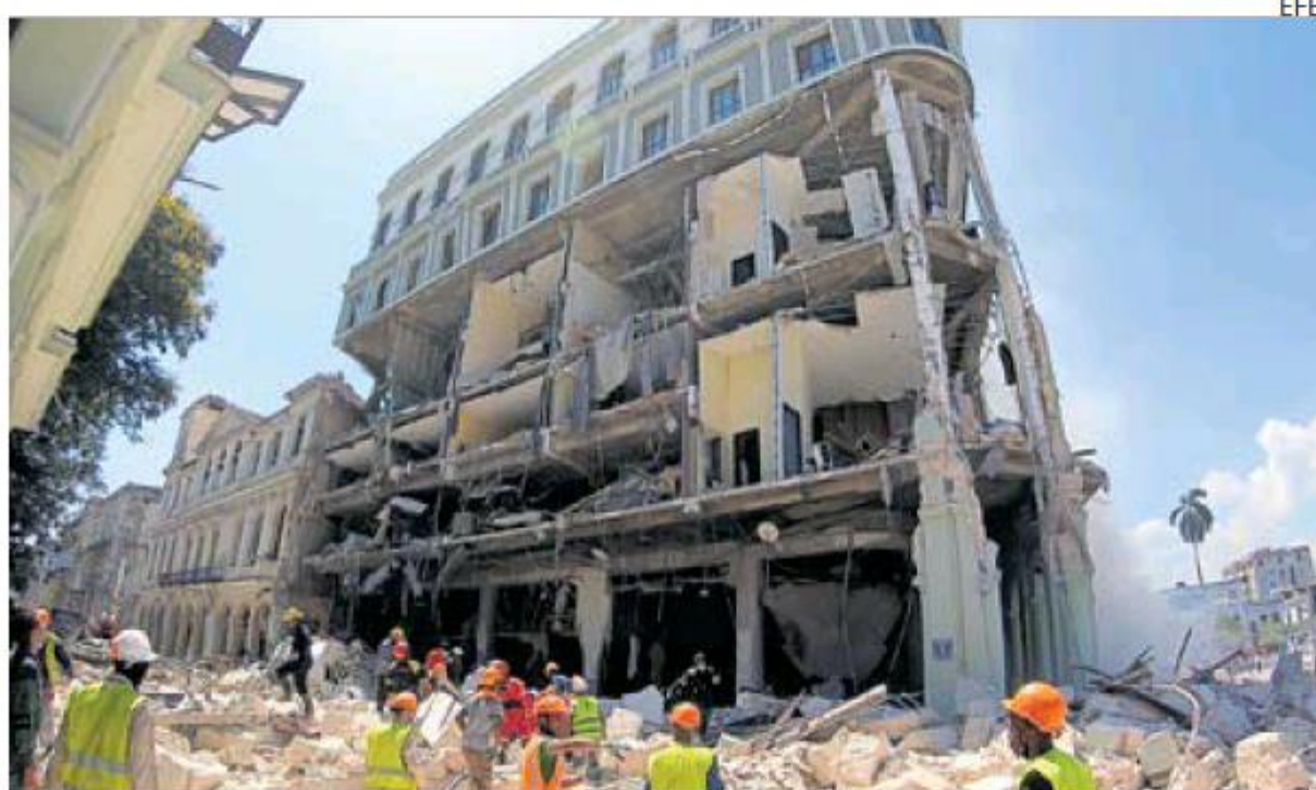
■ RESCATE. Socorristas buscan sobrevivientes entre escombros de hotel Saratoga.
